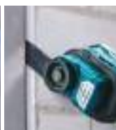
Corte de masilla de ventanas, silicona.
