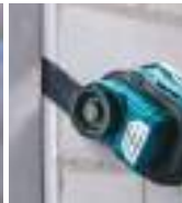
Corte de masilla de ventanas, silicona.
